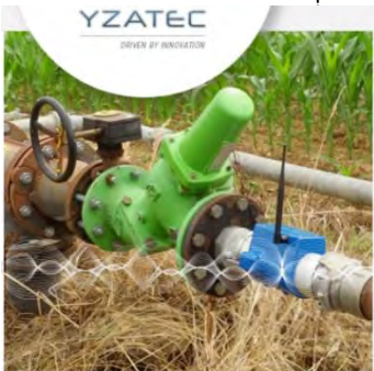
Des compteurs d'eau intelligents
